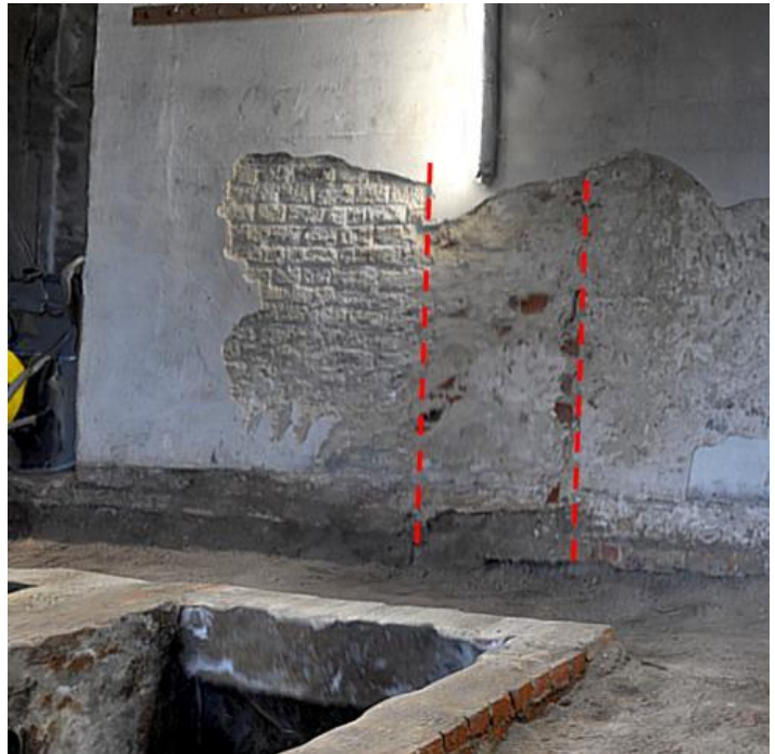
Figuur 9: Een verticale bouwnaad op de muur van het schip, in lijn met de uitgebroken muur 1
