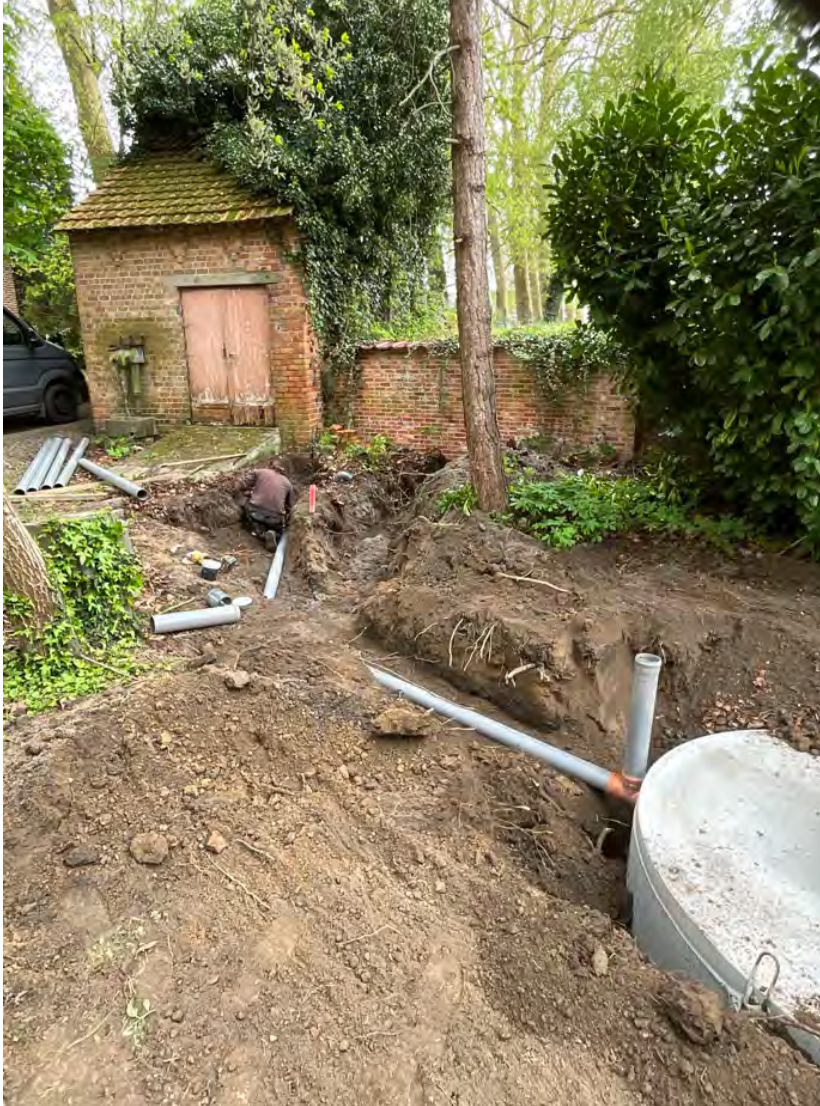
Opvolging van de sleuven voor de nutsleidingen in zone II, het pomphuis staat op de achtergrond, de septische put bevindt zich rechtsonder
