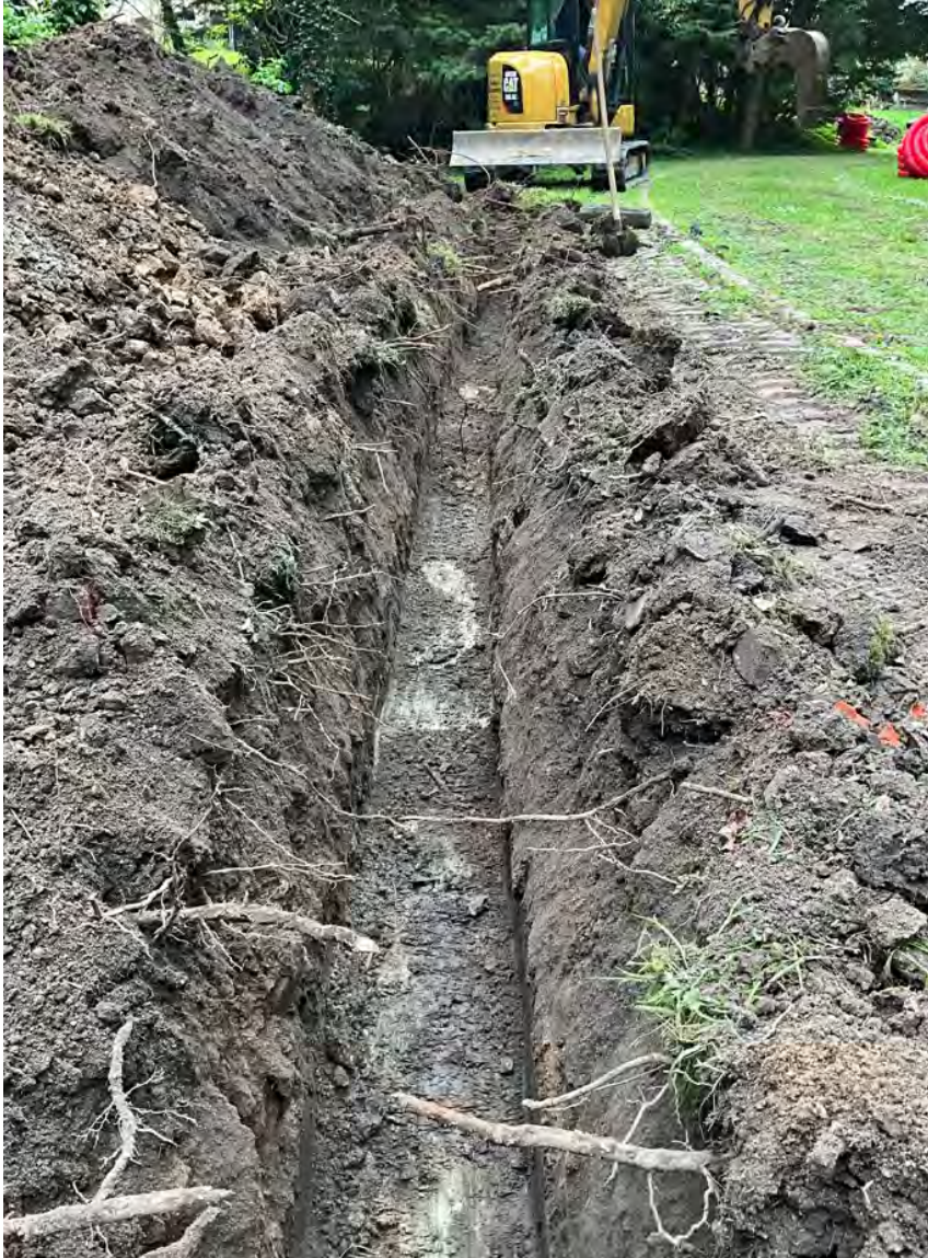
Opvolging van de sleuven voor de nutsleidingen in zone II, de motteheuvel bevindt zich rechts
